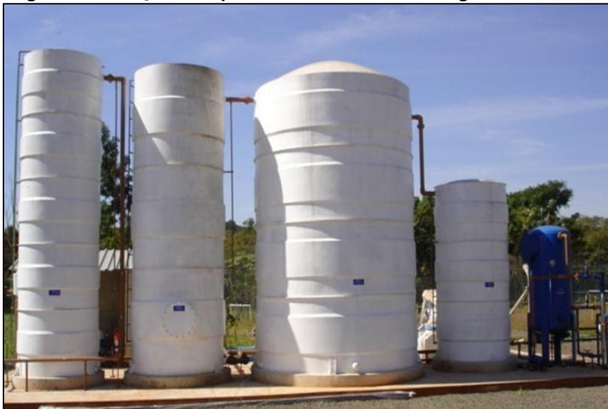
Figura 6 – Estação Compacta de Tratamento de Esgotos Sanitários.
